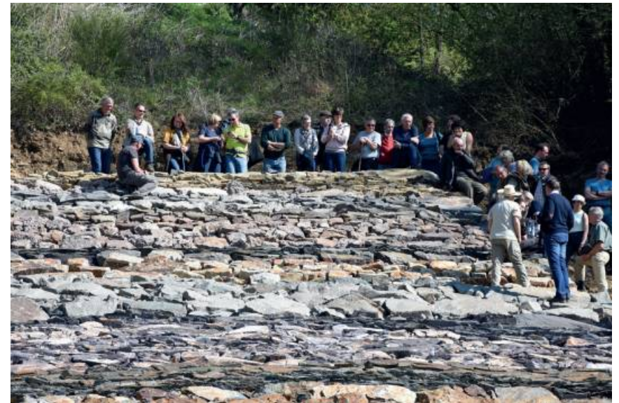
Fig. 44 - Une visite lors de la pose du grès famennien (couleur ocre au sommet de la construction).
